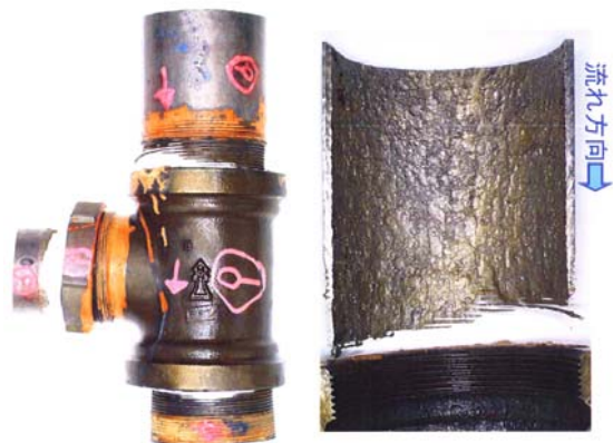
【減肉しネジ部が欠損した配管】
