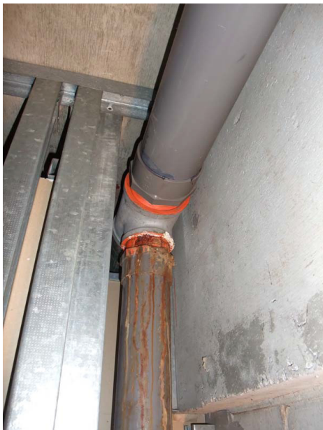
写真 9階のユニットバスのリフォームで見つかった通気管からの錆汁
