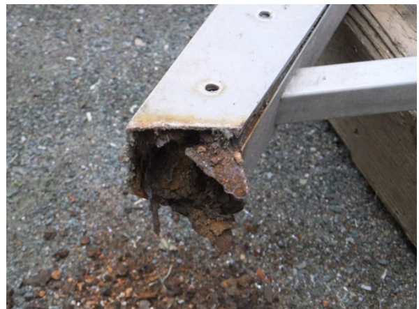
錆で崩れてしまった内部の鋼材
