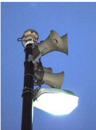
[非常放送設備]
