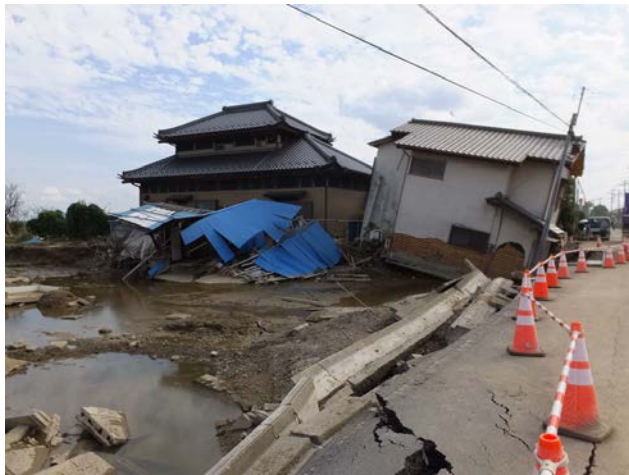
「平成 27 年 9 月関東・東北豪雨」の常総市の被害
